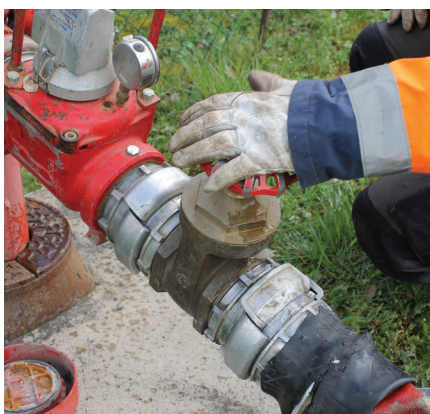
Les bornes incendie sont raccordées à la conduite d'eau principale
