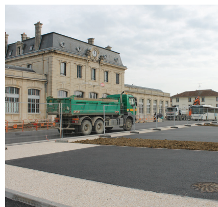
Financement, CC2T, Région Grand Est, État, et le département de Meurthe-et-Moselle. Coût total 1,75 M€ ht
